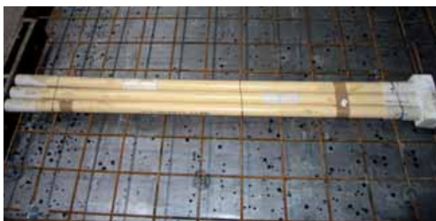
Figur 20. Hvor rørene munder ud på elementets flade anvendes ofte udsparingsklodser af ekspanderet polystyren. Billedet viser fremføring af 3 rør til en installationskanal. Væggen er enkeltarmeret, og rørene er fastholdt til armeringen med ståltråd, så de ikke forskydes under støbningen.
