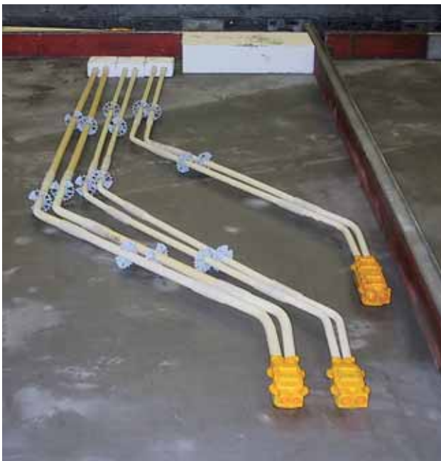
Figur 24. Rørbøjninger. En stor udspæring i toppen af elementet gør det nødvendigt at forskyde udmundingen af rørene. Placeringen af de 2 dåser ved siden af hinanden er kritisk mht. tolerancer. Hvis de tilsvarende dåser var placeret i opsidens, ville problemerne være endnu større. Elementer tilstræbes produceret, så el-installationer primært lægges i forsidens, hvor fastgørelsesmulighederne er bedre. Bemærk, at rørene går ikke helt til elementets top, men afsluttes i selve elementfladen. Der er anvendt bukkede rør, ikke standard-fittings.
