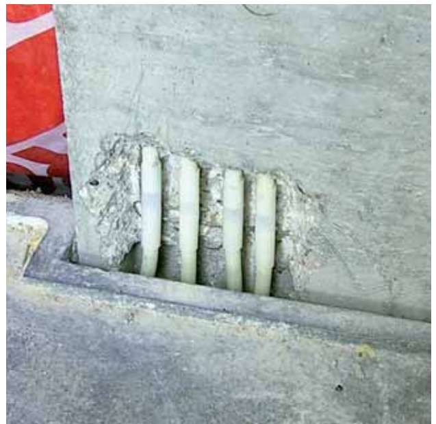
Figur 40. Rørføring mellem 2 elementer i en trapperums-væg ud for etageadskillelsen. Rørføringen, som er udført med flexrør, er delvis skjult af trappereposen. Den udsparring, der har været ved rørenes udmundning har tydeligvis ikke været stor nok. Det har været nødvendigt at hugge yderligere ud omkring rørene. Det vil kræve stor omhu at lave en pæn udstøbning omkring rørene bag reposen.
